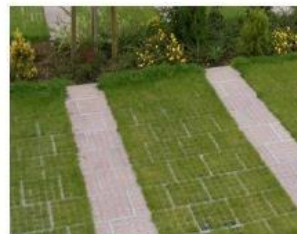
Solution mixte dalles alvéolaire/ pavés Source : Sol-aire
